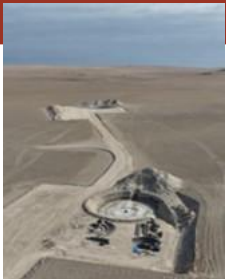
CARAVELÍ WF CELSIA; PERÚ; 220MW; 37xNI63-5.9MW
