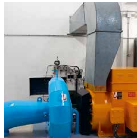
Central Hidroeléctrica de Quéntar (Etap Lancha del Genil).
