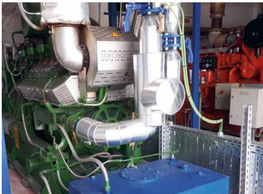
Motor de cogeneración.
