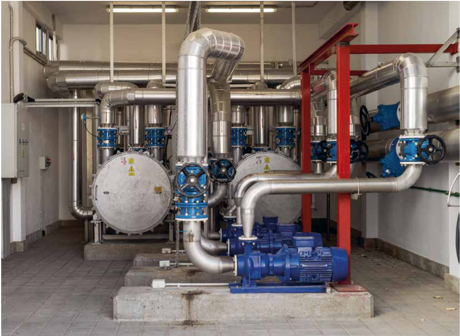
Depuradora en Emasagra.
